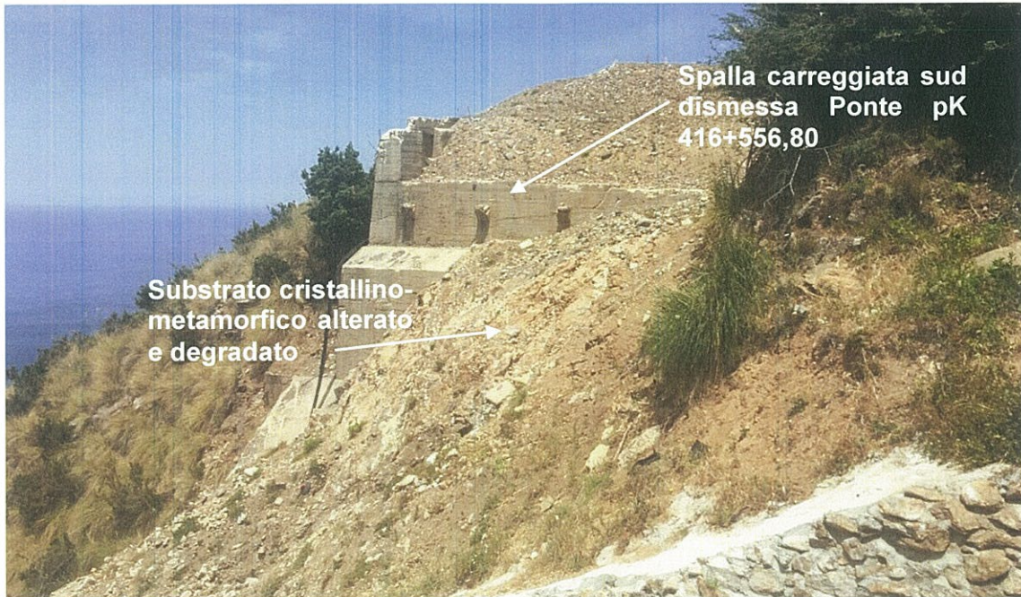
Foto 6.6 - Spalla nord carreggiata sud demolita del Ponte alla pK 416+556,80 dismessa a garantire un ruolo di sostegno alla porzione di versante posto a monte e caratterizzata da pendenze elevate.
