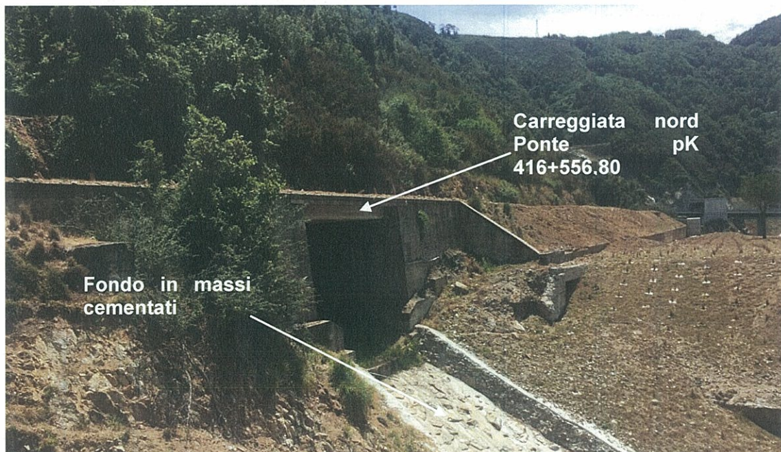
Foto 6.7- Vista della carreggiata nord Ponte alla pK 416+556,80, che contribuisce al corretto deflusso delle acque superficiali.
