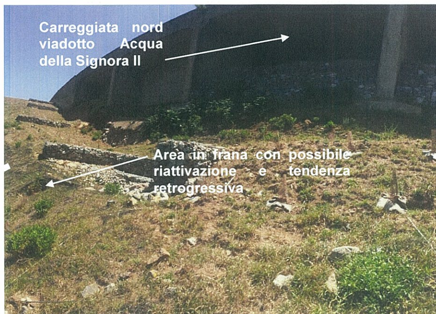
Foto 6.5 - Vista relativa alla carreggiata nord del viadotto Acqua della Signora II, opera che garantisce un ruolo di sostegno e protezione del versante, rispetto al fenomeno franoso posto a valle;
